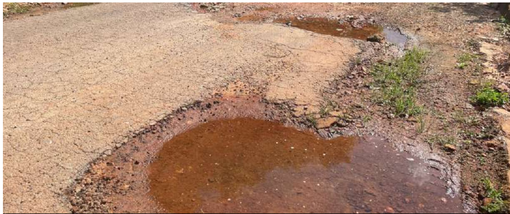
Buracos toma conta da rua Espanha
