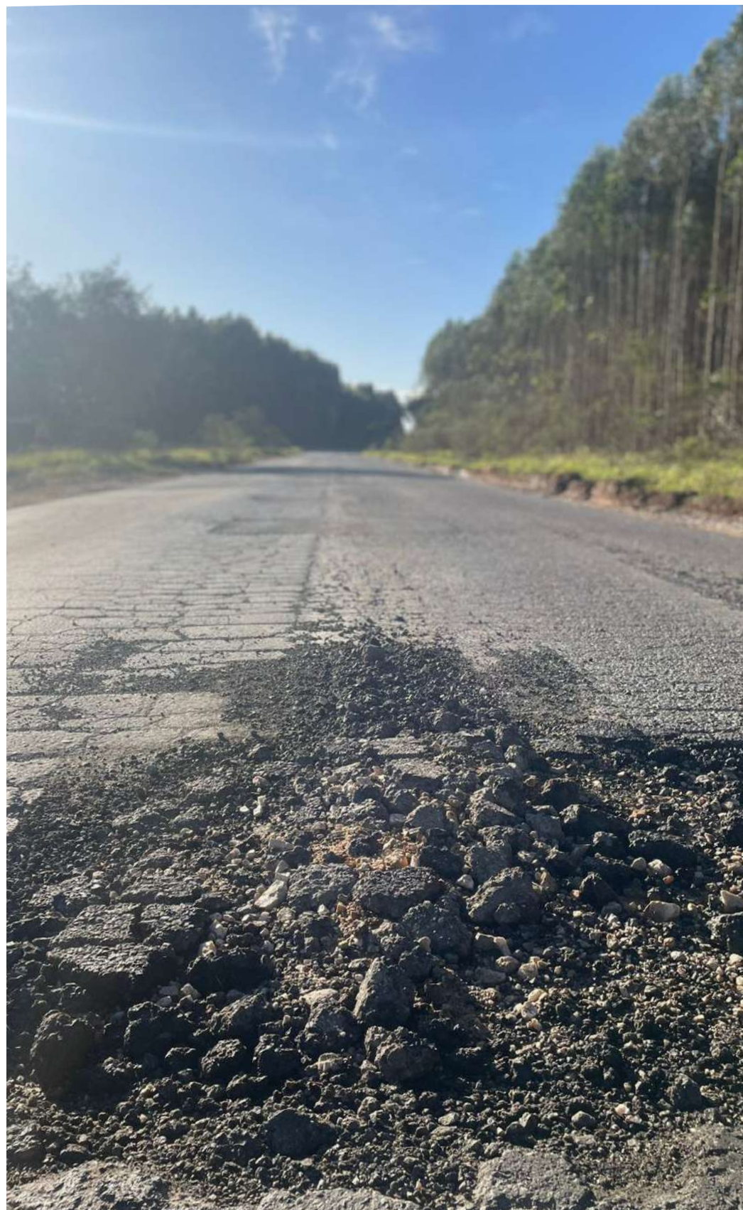
Prefeitura agora diz que obra em estrada para Buri é tapa-buraco
